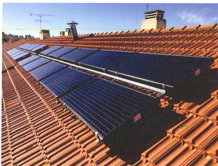
Figura 9 – Painéis solares híbridos atualmente instalados na Rua dos 3 Vales nº50
